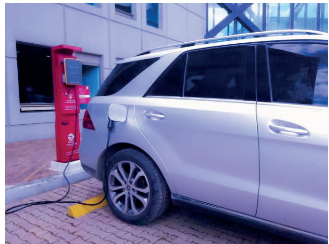
Estación de carga disponible para clientes de Banco Finandina. Equipos para los tres tipos de conexión disponibles en el mercado.
